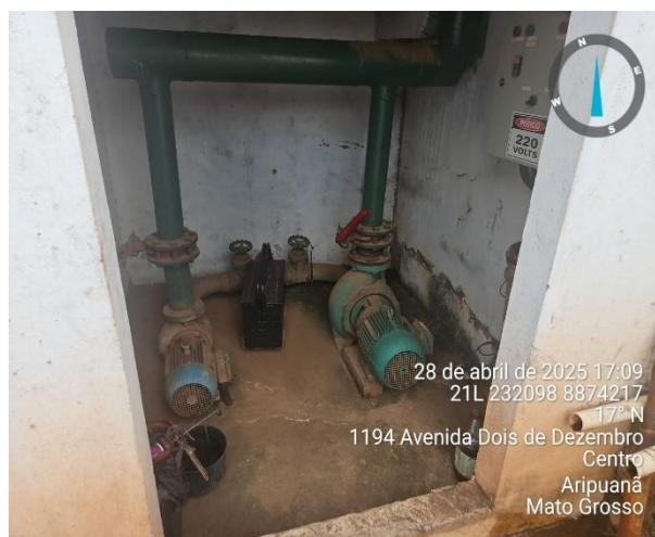
Figura 11 – Elevatória de água tratada (EEAT) - Adução para os reservatórios da ETA.
