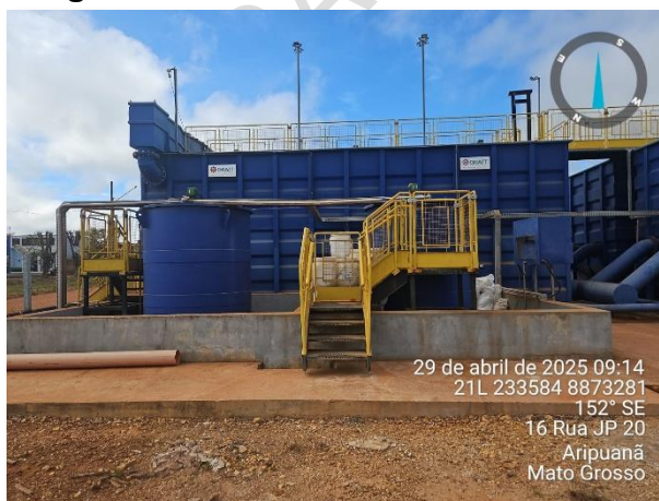
Figura 23 – Vista dos floculadores.
