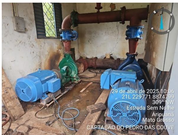
Figura 4 – Conjuntos moto-bomba da EEAB.
