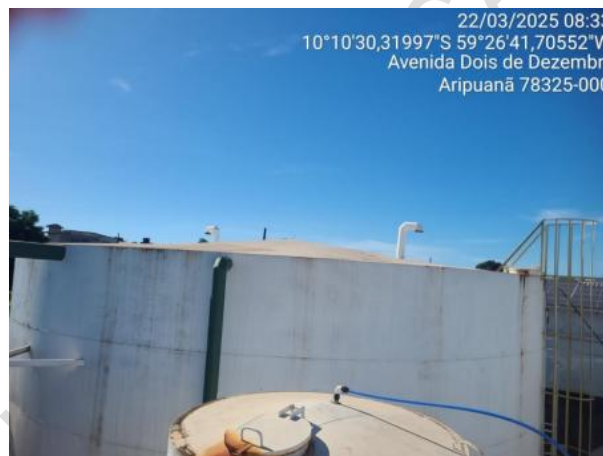
Figura 14 – Reservatório RAP-02 500m 3
