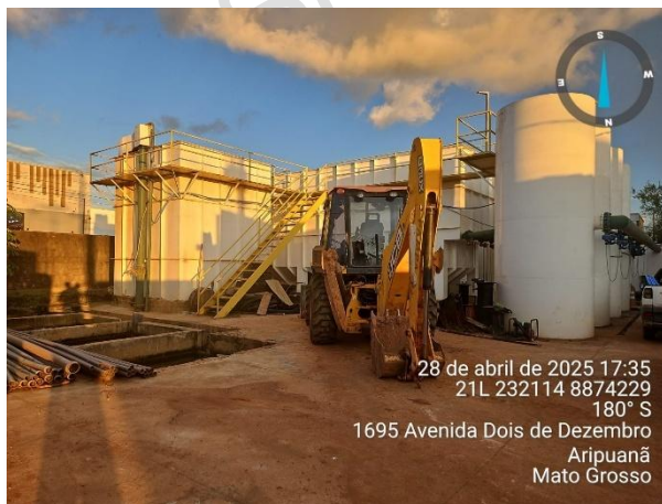
Figura 9 – Vista do módulo compacto de tratamento (ETA 1).
