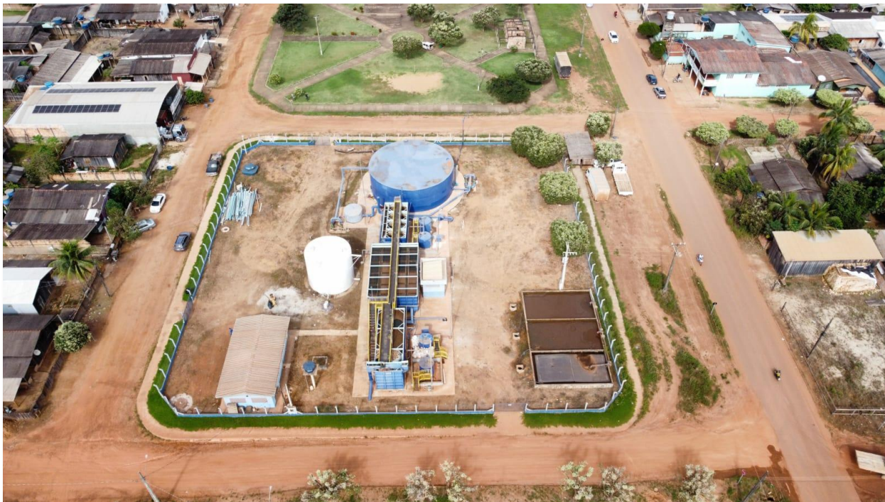
Figura 21 – Vista aérea da ETA Central.
