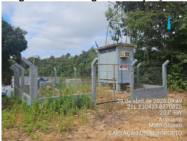
Figura 18 – Vista geral da captação.
