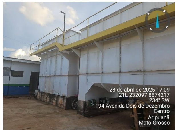
Figura 10 – Vista do módulo compacto de tratamento (ETA 2).
