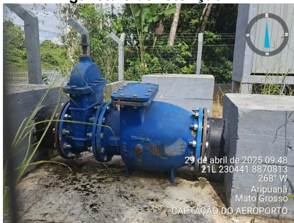
Figura 17 – Barrilete – Válvula de gaveta e de retenção.
