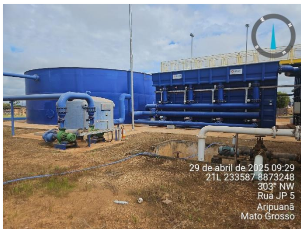
Figura 25 – Vista do decantador e RAP 700m 3 .
