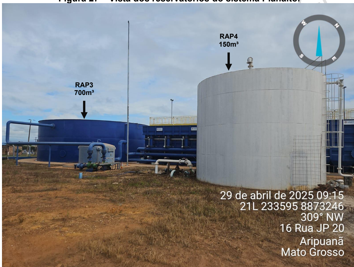
Figura 27 – Vista dos reservatórios do sistema Planalto.
