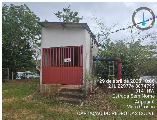
Figura 3 – Elevatória de água bruta.
