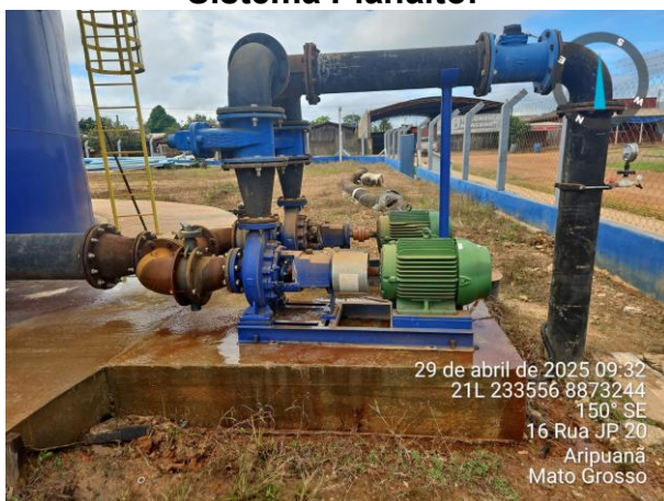
Figura 28 – Vista da EEAT 02 – Sistema Planalto.
