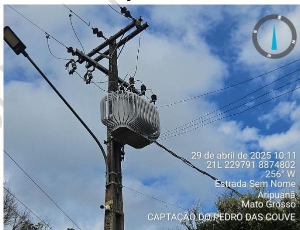
Figura 5 – Vista do transformador 112kVA adjacente à EEAB.
