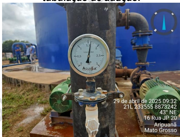
Figura 29 – Vista do manômetro da tubulação de adução.
