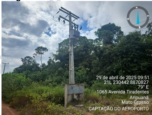
Figura 19 – Vista do transformador.
