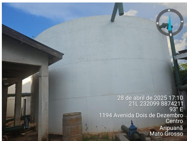
Figura 13 – Reservatório RAP-01 350m 3
