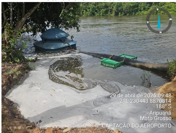
Figura 16 – Captação com CMB instalado em flutuante.
