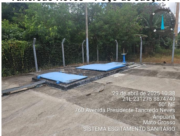
Figura 6 – EEE Av. Presidente Tancredo Neves – Poço de sucção.
