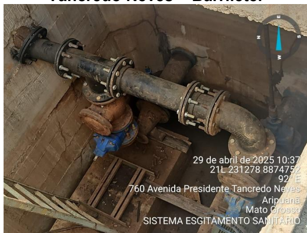
Figura 7 – EEE Av. Presidente Tancredo Neves – Barrilete.
