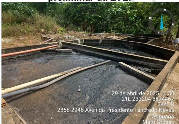
Figura 11 – Vista do tratamento preliminar da ETE.
