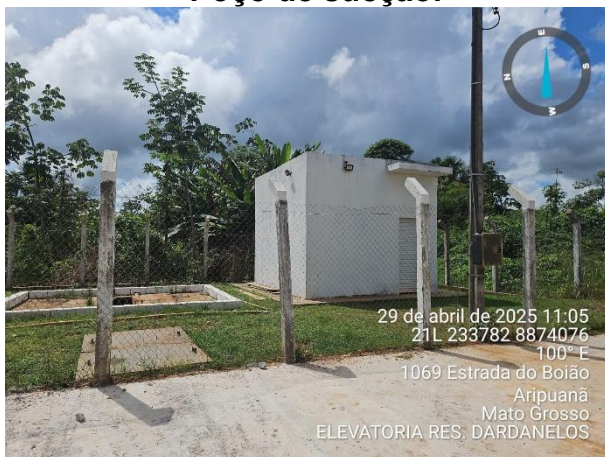
Figura 8 – EEE Residencial Dardanelos – Poço de sucção.
