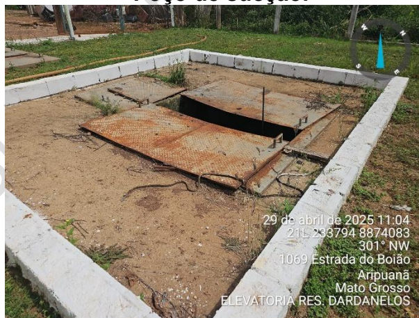
Figura 9 – EEE Residencial Dardanelos – Poço de sucção.
