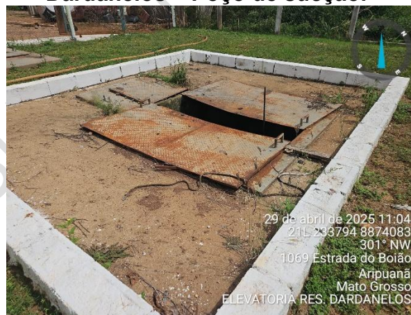
Figura 9 – EEE Residencial Dardanelos – Poço de sucção.
