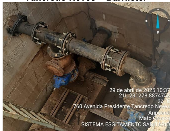
Figura 7 – EEE Av. Presidente Tancredo Neves – Barrilete.
