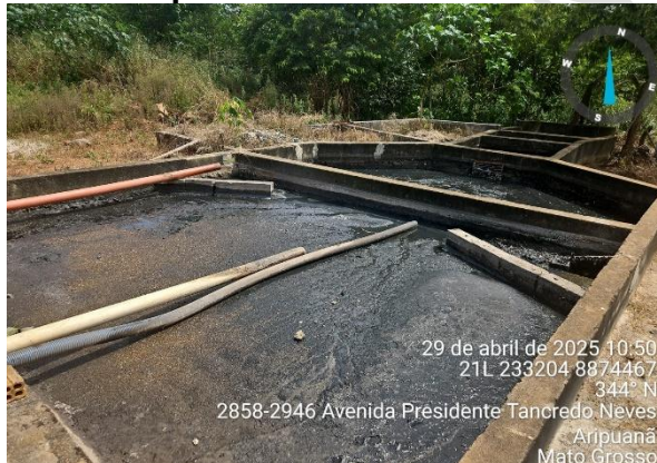
Figura 11 – Vista do tratamento preliminar da ETE.
