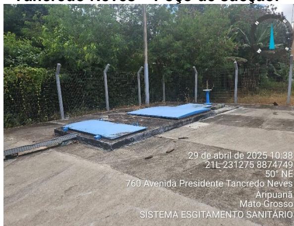
Figura 6 – EEE Av. Presidente Tancredo Neves – Poço de sucção.
