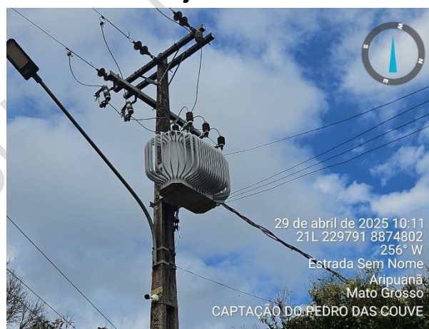
Figura 5 – Vista do transformador 112kVA adjacente à EEAB.
