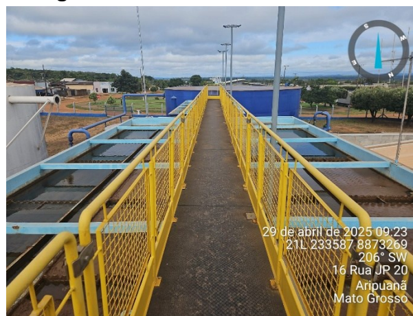
Figura 24 – Vista do decantador.
