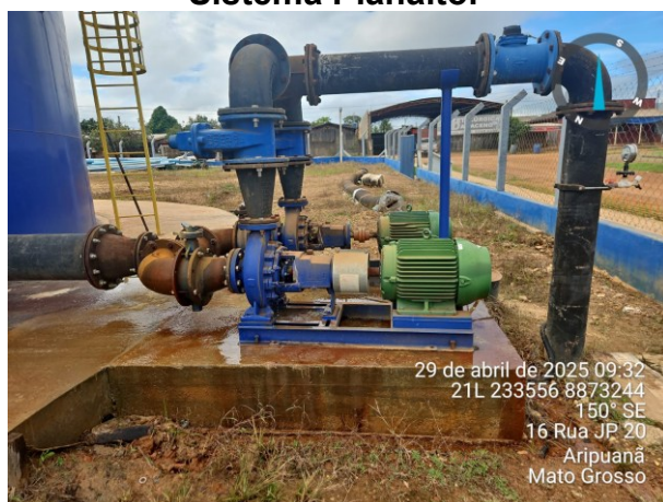
Figura 28 – Vista da EEAT 02 – Sistema Planalto.
