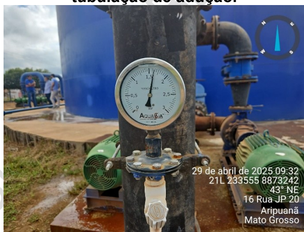
Figura 29 – Vista do manômetro da tubulação de adução.
