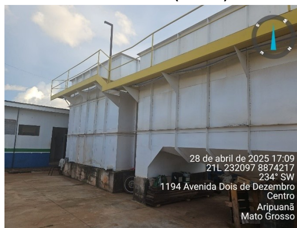
Figura 10 – Vista do módulo compacto de tratamento (ETA 2).
