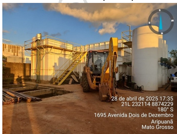
Figura 9 – Vista do módulo compacto de tratamento (ETA 1).
