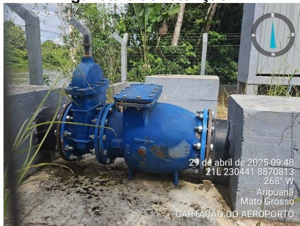
Figura 17 – Barrilete – Válvula de gaveta e de retenção.
