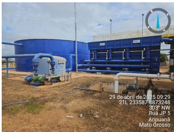
Figura 25 – Vista do decantador e RAP 700m³.
