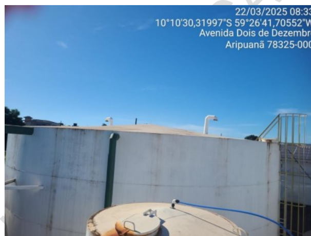
Figura 14 – Reservatório RAP-02 500m³
