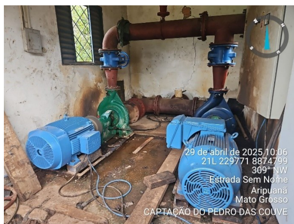
Figura 4 – Conjuntos moto-bomba da EEAB.
