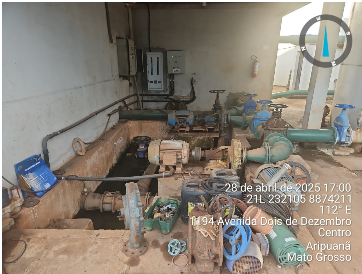
Figura 15 – Vista da EEAT 01 – Sistema Central.
