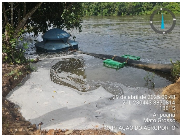
Figura 16 – Captação com CMB instalado em flutuante.
