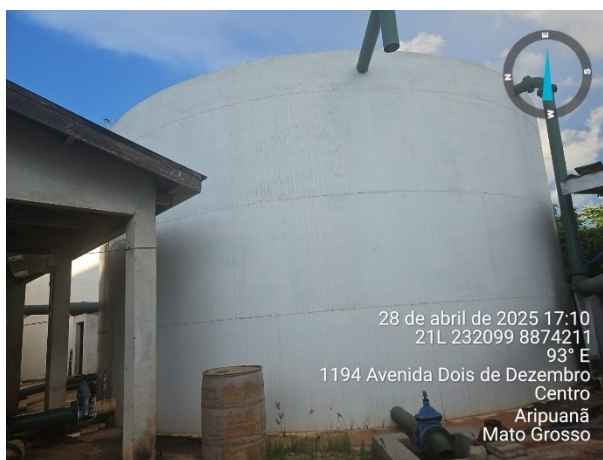
Figura 13 – Reservatório RAP-01 350m³
