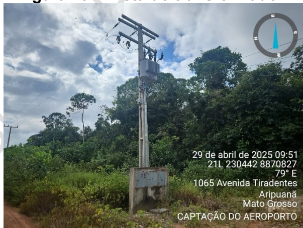
Figura 19 – Vista do transformador.
