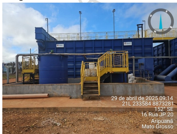
Figura 23 – Vista dos floculadores.
