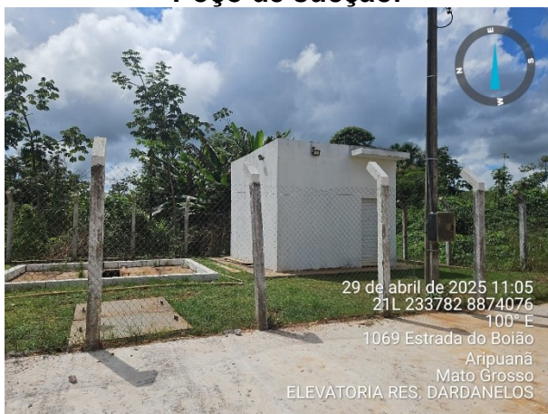
Figura 8 – EEE Residencial Dardanelos – Poço de sucção.
