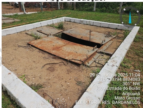
Figura 9 – EEE Residencial Dardanelos – Poço de sucção.
