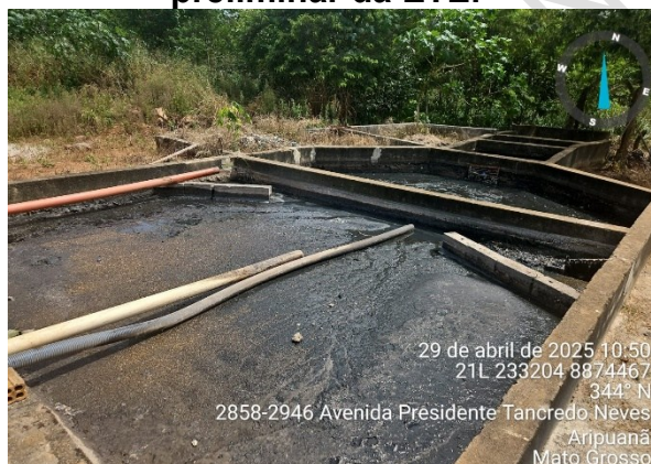
Figura 11 – Vista do tratamento preliminar da ETE.
