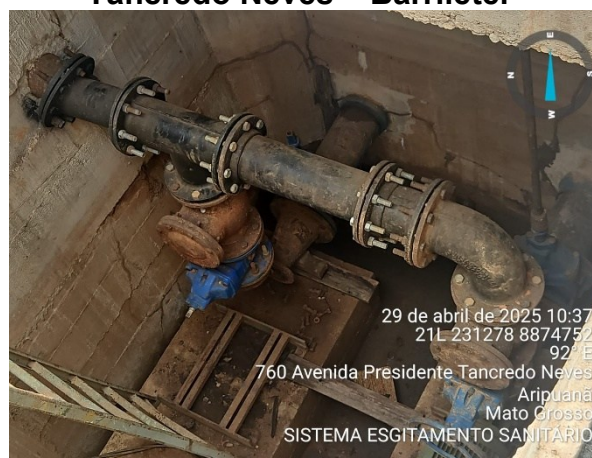
Figura 7 – EEE Av. Presidente Tancredo Neves – Barrilete.
