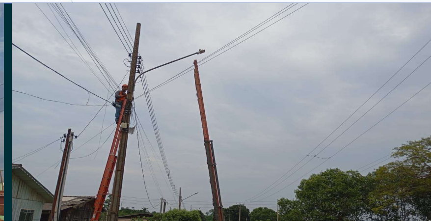
Latitude: -10.172504 Longitude: -59.458427 Elevação: 227.6±1 m Precisão: 12.6 m Tempo: 26-10-2024 09:05 Nota: Rua Francisco Teixeira de Sousa, módulo 1 troca luminária 100w por led 50w, programa M Ilu
