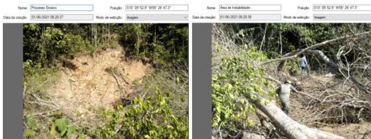
Fotos 09 e 10 – Área de Instabilidade na margem do rio Aripuanã.
